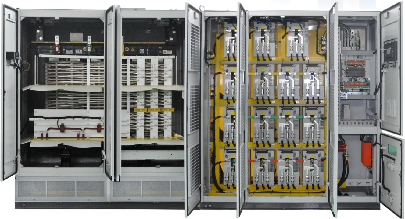
В Шкаф трансформатора
